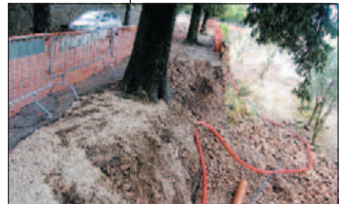
Il tratto di muro crollato in viale Poeta a Spello con i tigli secolari che rischiano di cadere a terra per lo sfaldamento del terreno
