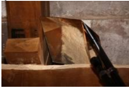
Esempio di distruzione totale di una trave
