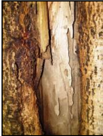
Fessurazioni longitudinali causate dalle termiti
